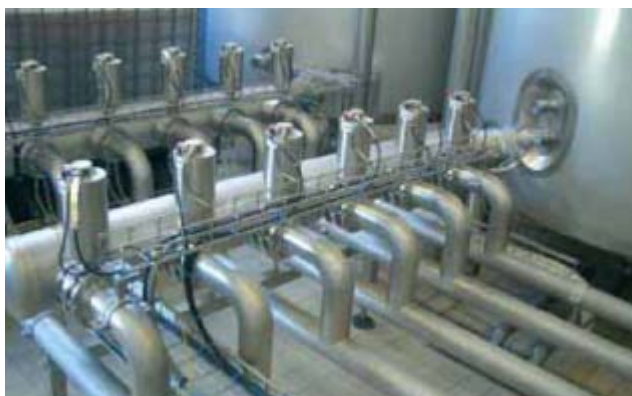
Automatiska avstängningsventiler på det nya helautomatiska rengöringssystemet i Pfaffenhofen.
